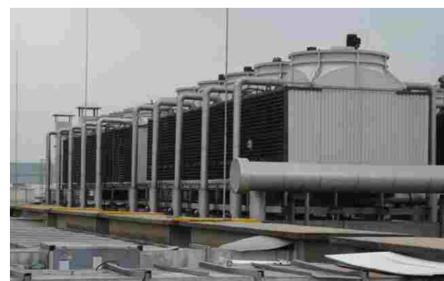
Системы вентиляции/кондиционирования и водоснабжения
