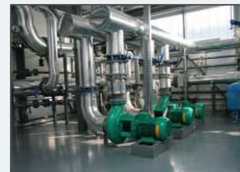
ОВК и водоснабжение
